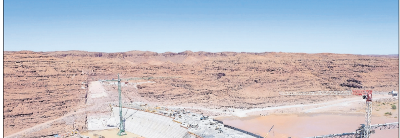
Bouwerk aan die Neckartaldam in die Visrivier naby Keetmanshoop moet in Desember vanjaar voltooi wees. FOTO VERSKAF
